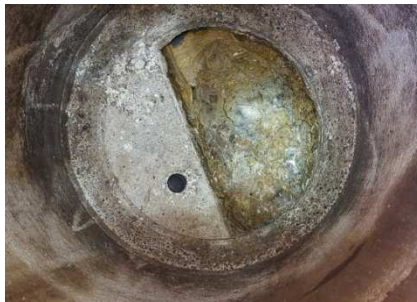
Kommunal avloppsbrunn igensatt med fett.
