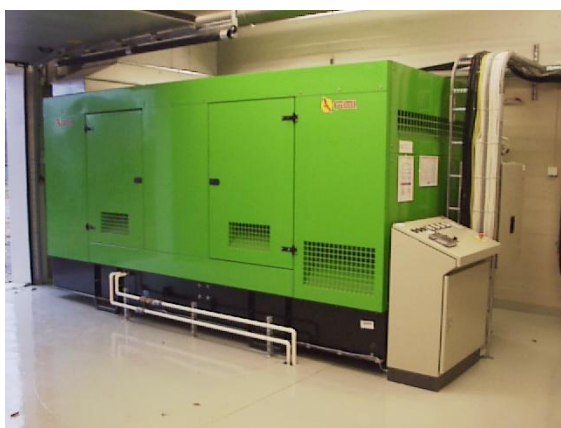
Figur 6 – Reservdiesel vid Fredriksbergs vattenverk
